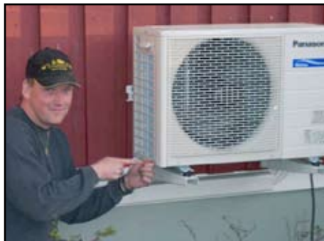
Ännu en ny installation av Bengt Lindberg, Stornäsuddens VA
